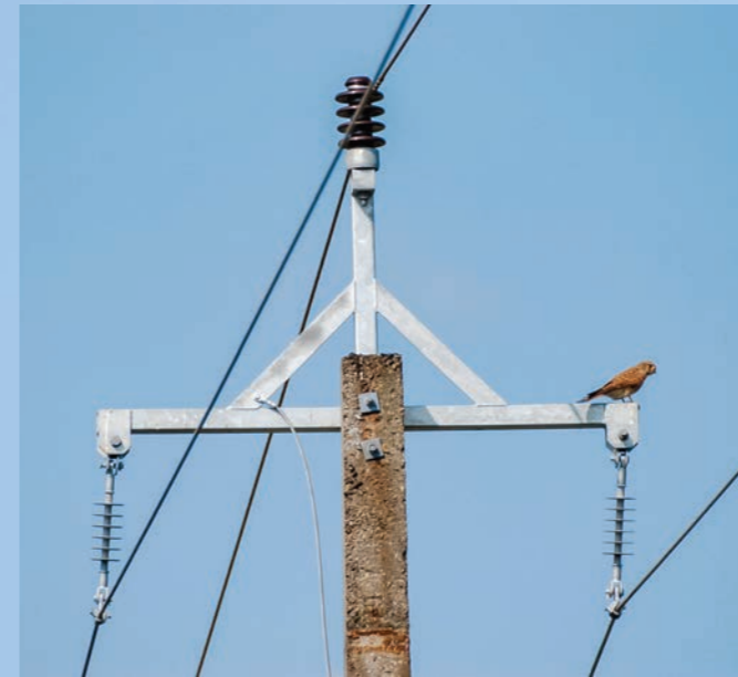
Madárbarát oszlopfej szerkezet függesztett vezetékekkel
